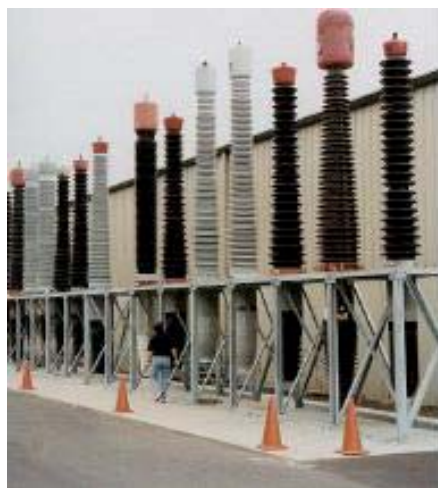
شکل ۵-۱۲ مهار بندی تجهیزات یدکی در انبار
