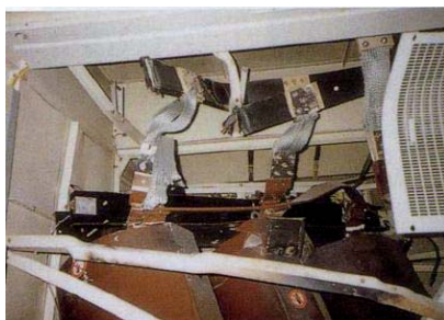
شکل ۹-۸ آسیب دیدگی قسمت‌های اطراف ترانسفورماتور
