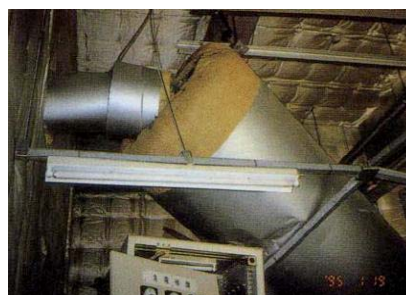
شکل ۹-۵ آسیب دیدگی عایق صدا
